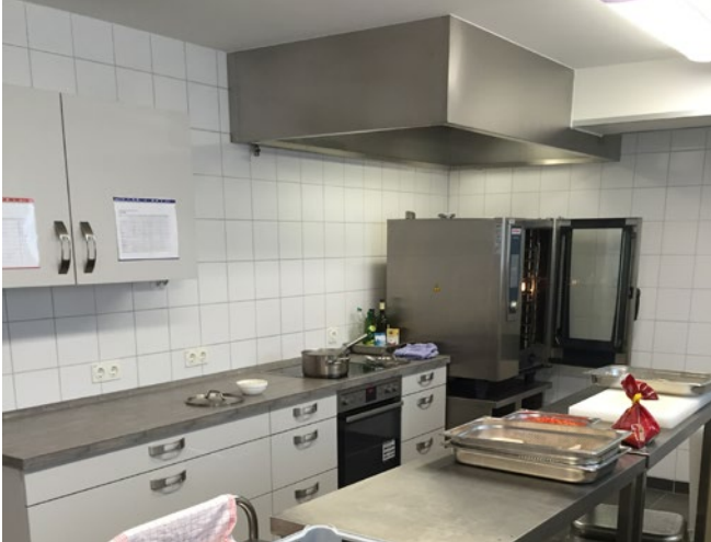
Abb. 29 Eine ausreichende Luftabsaugung ist erforderlich.
